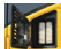
Filtro externo do ar condicionado
