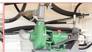
BOMBA DE DIESEL
